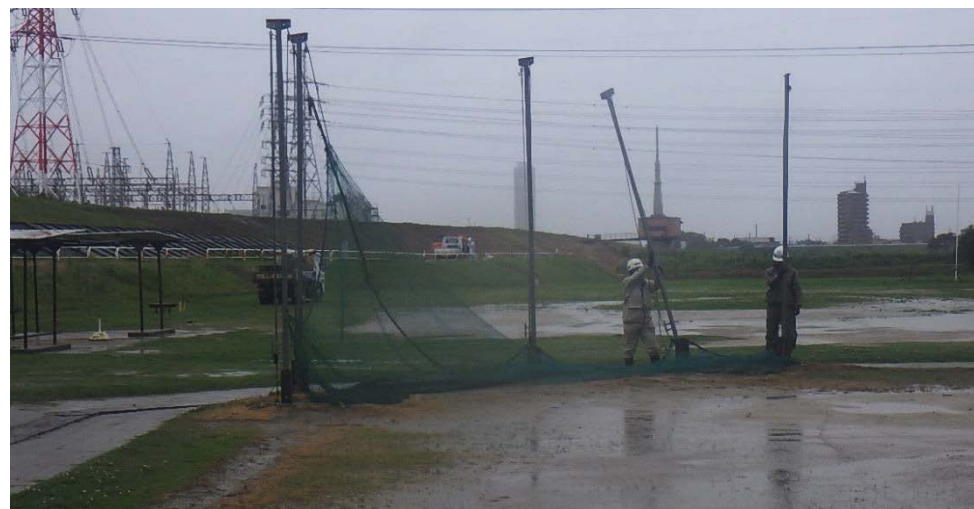
ソフトボール場バックネット取り外し・流水の妨げにならないよう支柱転倒
